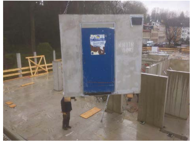
Abb. 21 Hamburg-Harburg: Die Leichtbeton-Nasszellen werden geschossweise mit dem Kran platziert. [© Andreas Hartmann/TU Berlin]
