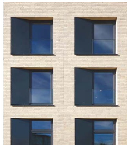
Abb. 59 Heiligenhaus: Die schräge Verkleidung der Zuluftelemente in den Fensterlaibungen in Heiligenhaus verbessert den Lichteinfall und den Ausblick. [© BBSR]
