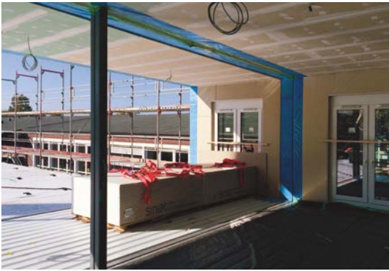
Abb. 29 Hamburg-Steilshoop: Die Modulbauweise verkürzte nicht nur die Bauzeit, sondern half auch Bauwerkskosten einzusparen. Die Raumzellen wurden komplett mit Fenstern, Trockenbau und vorinstallierter Elektrik geliefert. [© Susanne Rexroth/BF Vario]
