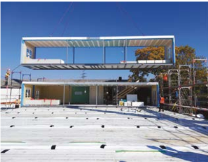
Abb. 25 Hamburg-Steilshoop: Durch die gewählte Modulbauweise konnte das Modellprojekt in kürzester Zeit errichtet werden. [© Christina Hagenhoff/BF Vario]
